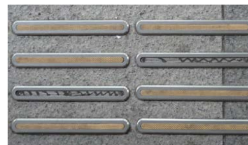
補修前の不具合
