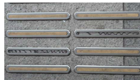
補修前の不具合
