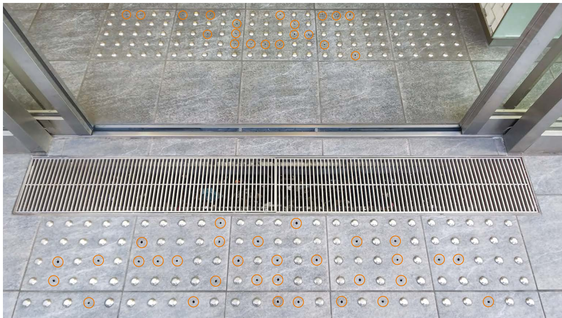
鋏の脱落箇所
